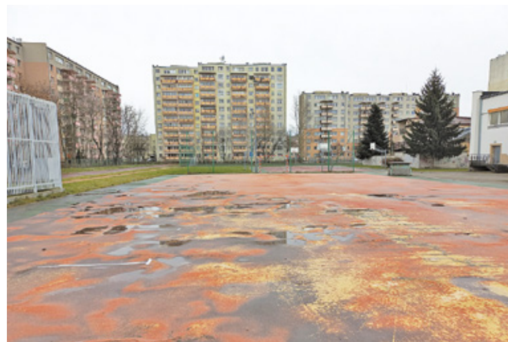
Plac wymaga remontu
