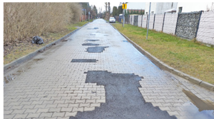
Droga prowizorycznie naprawiona
