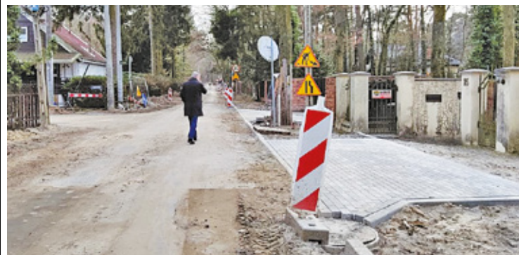
Miasto wybudowało i utwardziło 18 km dróg, a kolejne podkowieńskie ulice są remontowane
