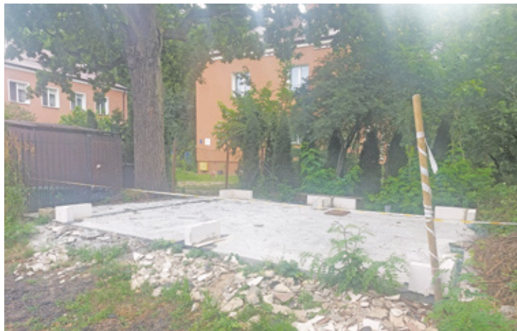
Niedaleko Miejskiego Targowiska w centrum miasta ktoś wylał betonowy fundament
