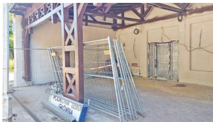
Na stacji WKD Podkowa Leśna, gdzie zaczęła miała zostać ofiara napadu, trwa remont
