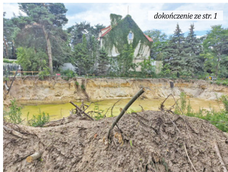
Wykop został zalany
