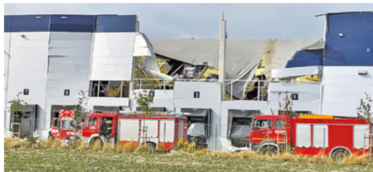
Strażacy przeszukiwali zawaaloną część hali za pomocą drona i psa tropiącego, poszukując rannych
