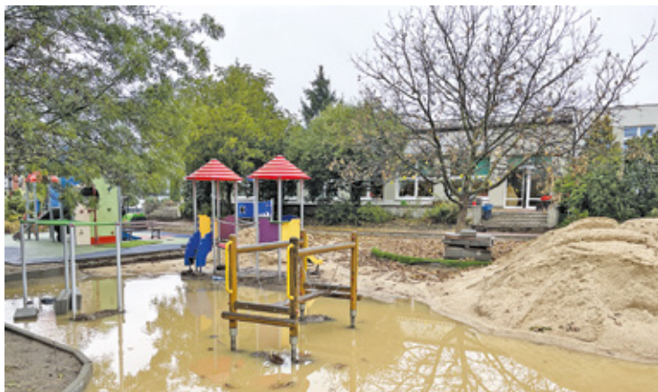
Na remontowanym placu zabaw pojawiło się nieplanowane oczko wodne
