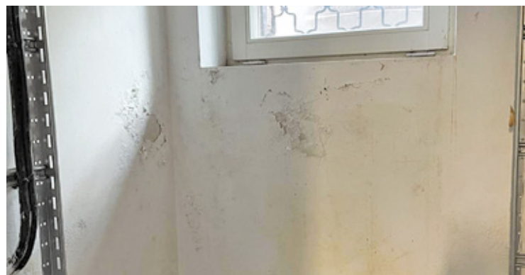
Wilgoć dostała się do piwnicy
