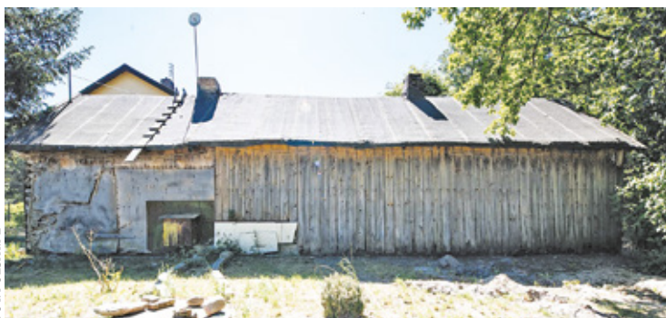
Rodzina mieszkała w starym, spróchniałym, dziurawym domu z nieszczelnym dachem
