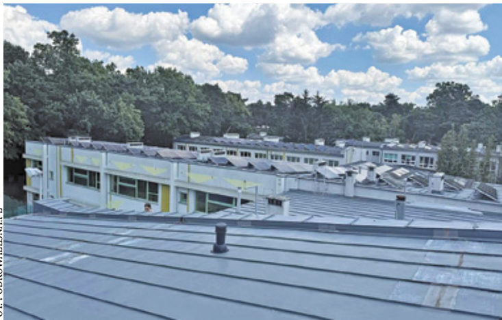
Głównymi przyczynami przecieków są pęknięcia w poszyciu dachu oraz niewłaściwa wentylacja i brak odpowiednich szczelin pod pokryciem dachu
