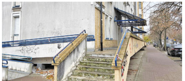
Budynek jest w bardzo złym stanie technicznym. Wymaga gruntownego remontu
