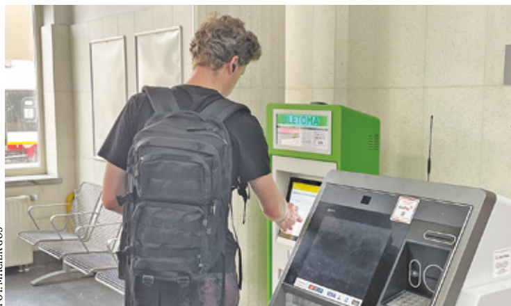
Nowy biletomat w Piastowie został zainstalowany w budynku dworca. Podróżni mają do niego swobodny i wygodny dostęp
