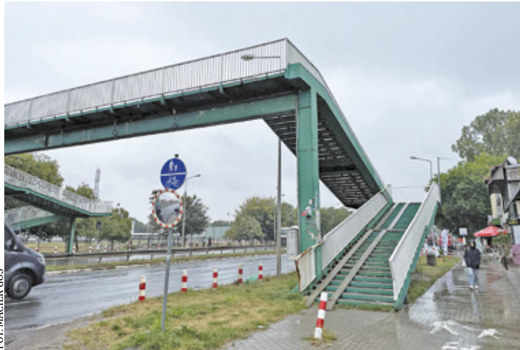
Część mieszkańców uważa, że zamiast kosztownego remontu, lepiej byłoby zbudować przejście z sygnalizacją świetlną
