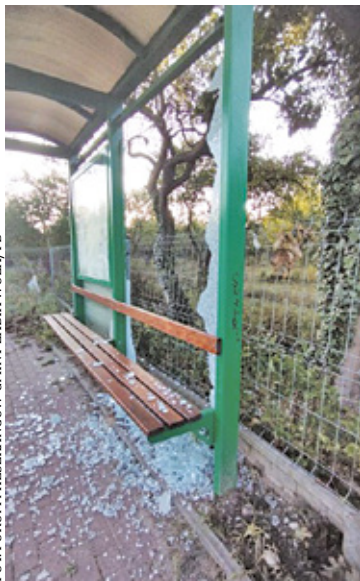
Zniszczony przystanek autobusowy w Grzegorzewicach. Nieznany sprawca (bądź sprawcy) wybił szyby i pozostawił pokruszone szkło
