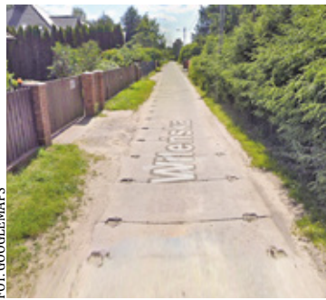
Ul. Wileńska jest obecnie zbudowana z płyt betonowych i wymaga pilnego remontu
