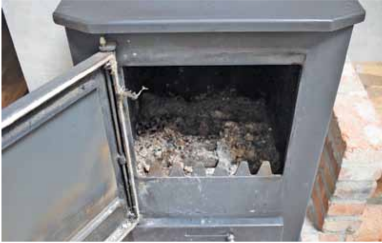
Najważniejsza jest konserwacja, czyszczenie i przeglądy techniczne instalacji gazowych i kominów
