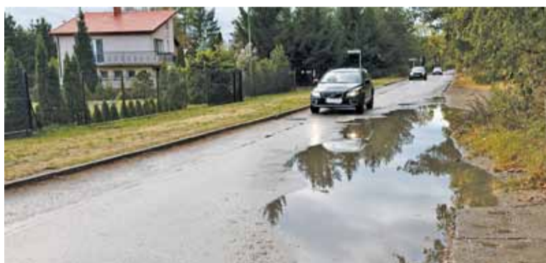
Wielkie kałuże to standard po każdym, nawet niewielkim deszczu
