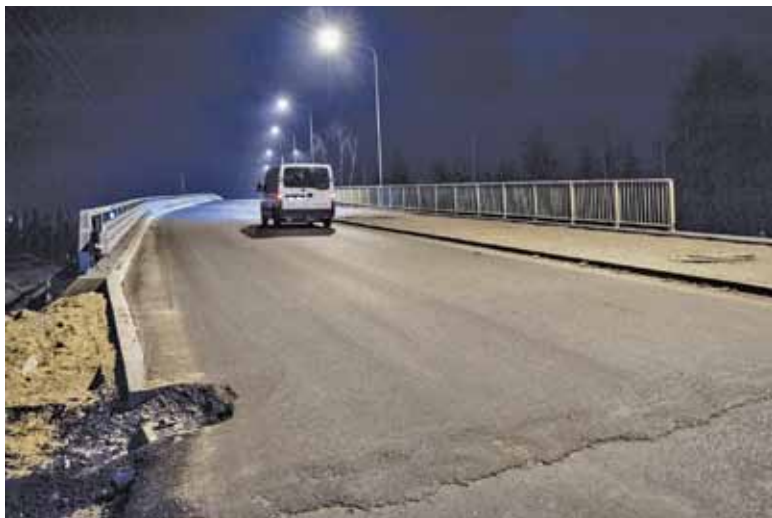
Przejazd nadarzyńskim wiaduktem jest już bezpieczniejszy, ale nieoznaczona studzienka jest dalej groźna
