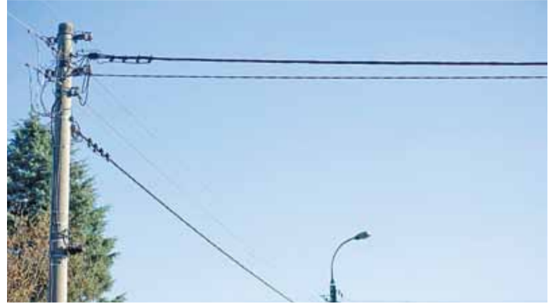
Na Żwirki i Wigury wiele budynków ma przyłącza napowietrzne, może to jest sposób na rozwiązanie problemu?
