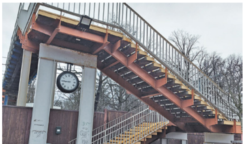
Kładka przy ulicy Przeskok doczeka się wreszcie remontu. Znalazła się w budżecie na 2022 rok
