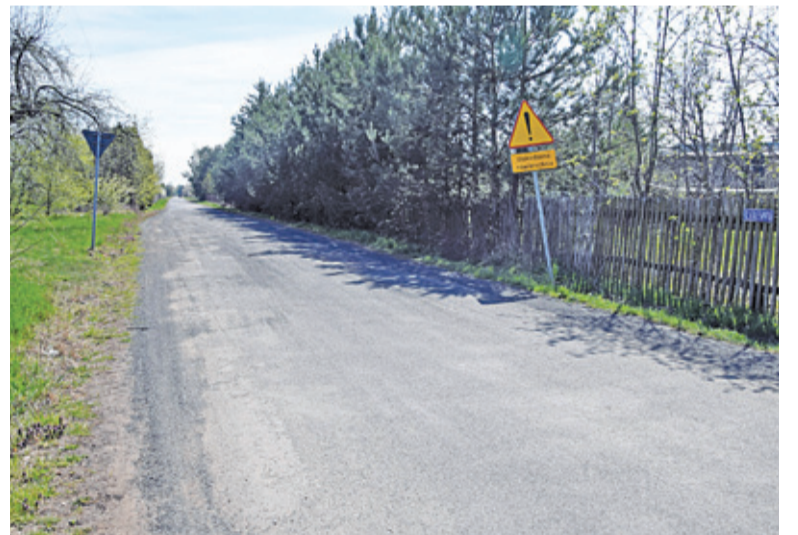
Ulica Kresowa w Ojrzanowie wymaga szybkiej przebudowy
