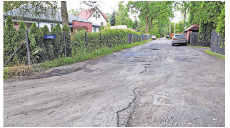
Ulice Owczarska i Mieszka I znajdują się w fatalnym stanie technicznym
