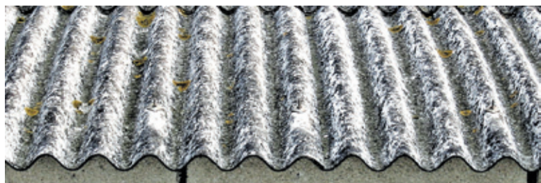
Płyty eternitowe stanowią ogromne zagrożenie dla ludzi
