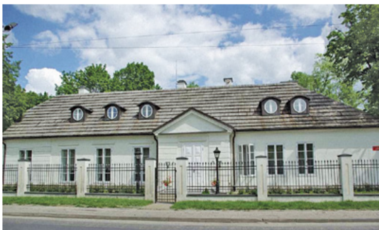
Konserwator oczekuje m.in. wymiany stolarki okiennej, odwodnienia piwnic i naprawy ubytków w elewacji
